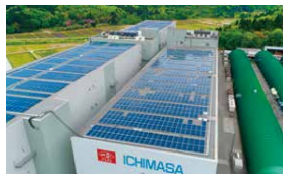
太陽光パネル
