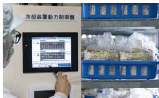
デジタル技術を活用した空調システム
